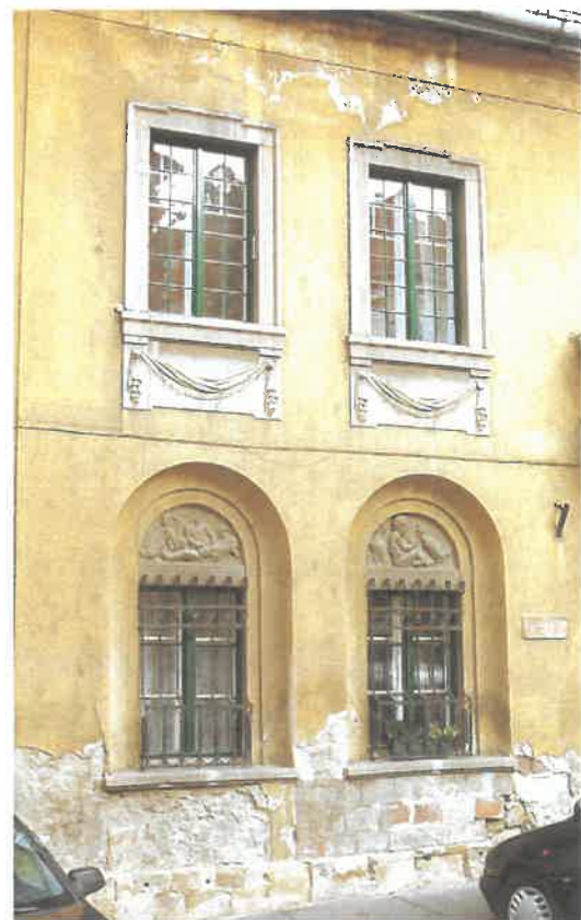
Épen megmaradt ablakkeretelések, ablakdíszek, felfagyott lábazat, vakolathibák
