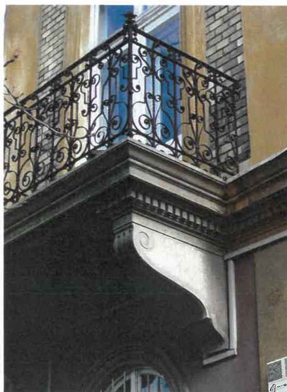
A homlokzaton vezetett kábelcsatorna nagyon zavaró
