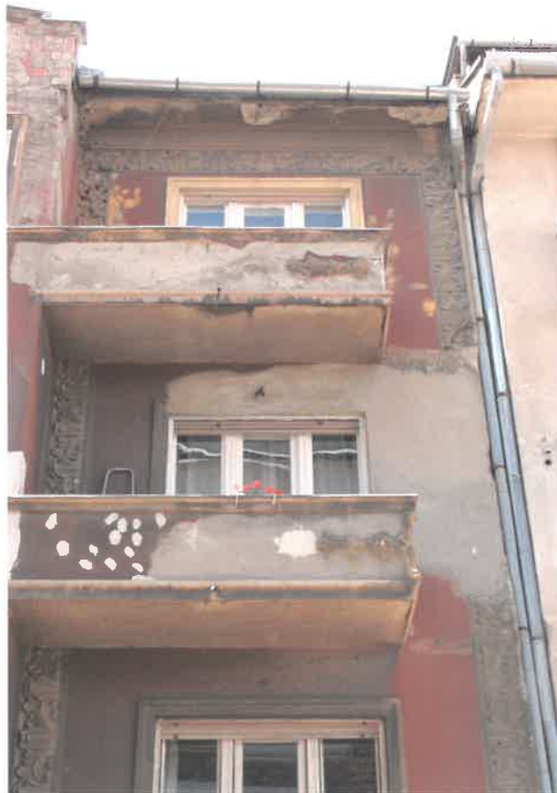
hiányos műkő keretelés
