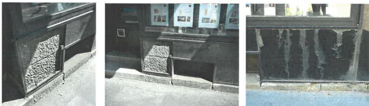
A földszinti kőburkolatot elfedő hiányos, részben tönkrement fekete műanyaglapborítás az üzletportálok körül a ház bal oldalán – lebontandó!
