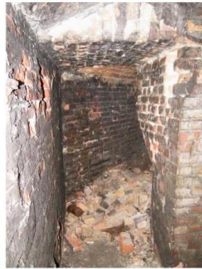
A tönkrement folyosói szakasz
